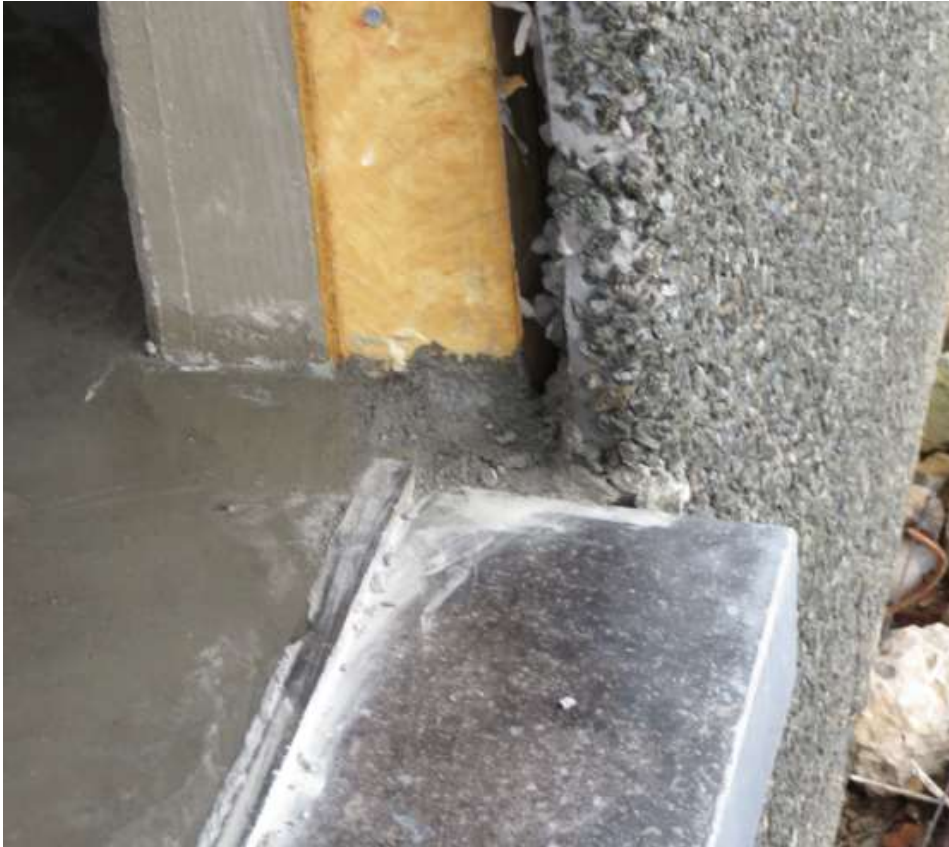
Figuur 24. Deurdorpel op correcte plaats maar onzorgvuldige aansluiting op vloer en wand.
