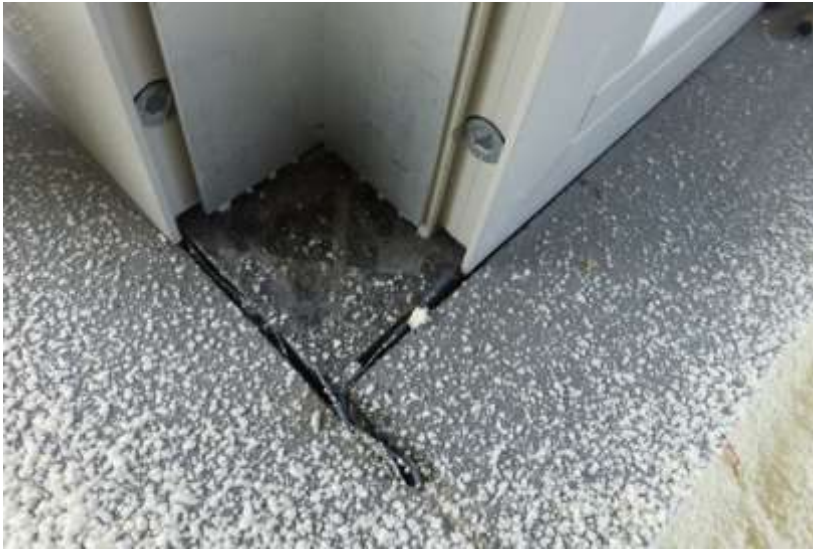
Figuur 18. Ramen staan volledig op de dorpel. De drukvaste, zwarte isolatie dient tot niets.
