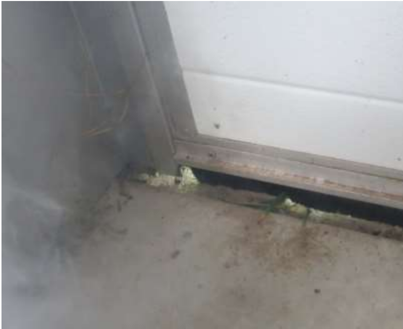
Figuur 20. Luchttek onderaan deur.
