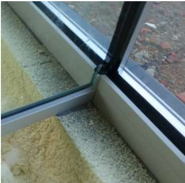
Figuur 16. Etalageraam lijkt in contact met drukvast isolatiemateriaal.
