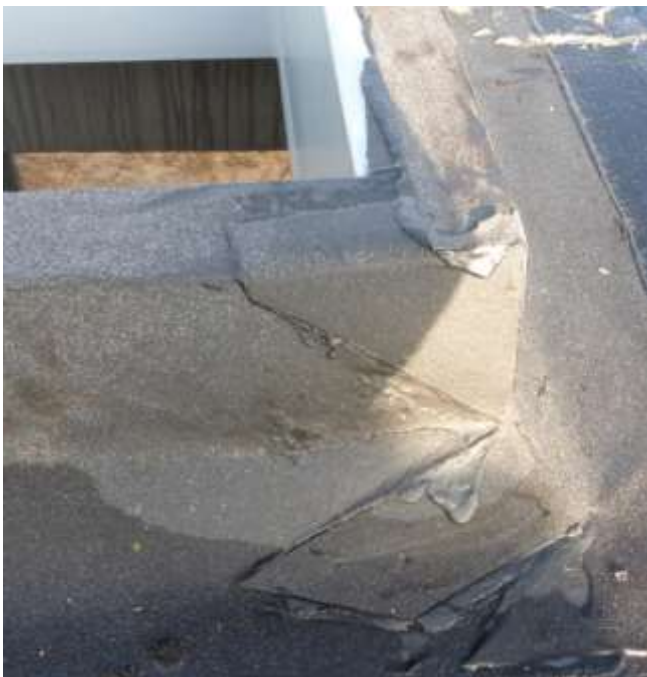
Figuur 47. Dakafdichting ter hoogte van een L-profiel voor montage van de lichtstraat.
