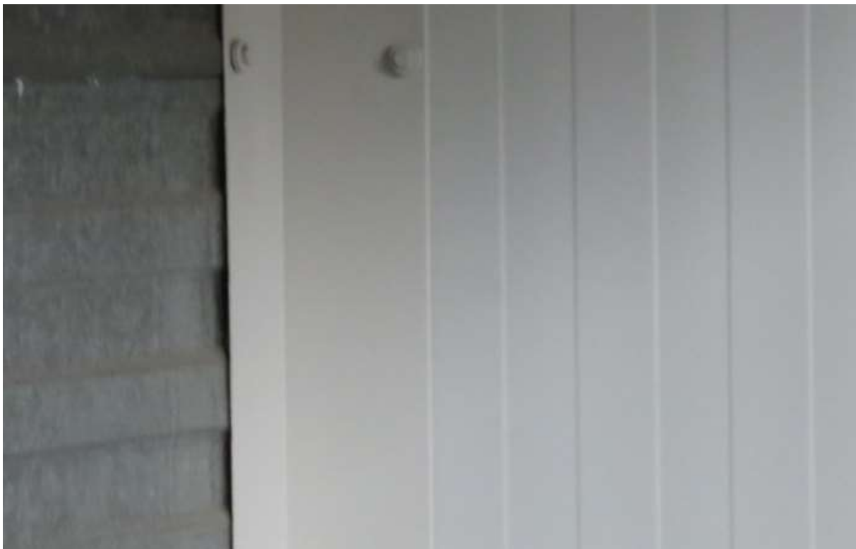
Afbeelding 16. Onvoldoende afdichting tussen scheidingswand en buitenmuur.
