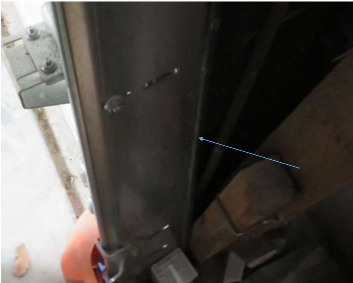
Afbeelding 19. luchtlek langs de zijdelingse aansluiting van de poort.
