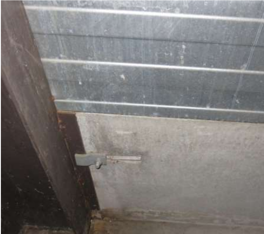
Afbeelding 14. Luchtlek ter hoogte van de aansluiting tussen de betonplint en binnendoos.
